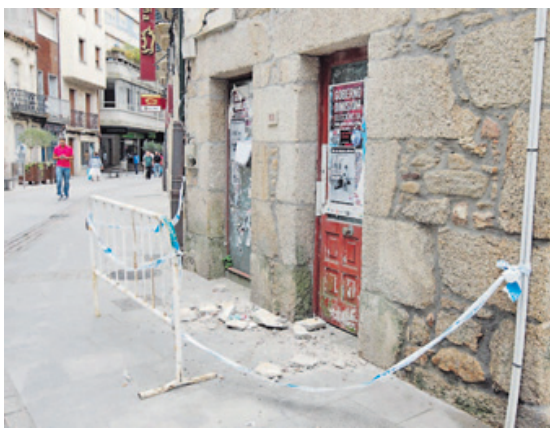
CASA EN MAL ESTADO EN EL CENTRO DE RIBEIRA
