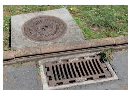
BT516 - SUMIDORIO METÁLICO
